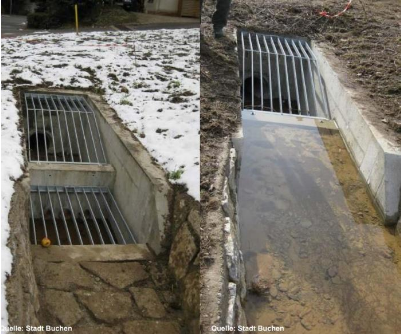
Einlaufbauwerk mit Schlamm-/Geröllfang (rechts nach Starkregen)
