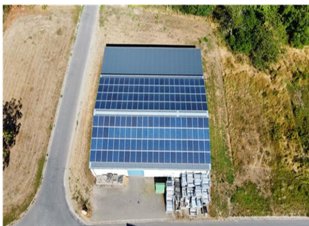
Abbildung 44: PV-Dachflächenanlage (Quelle: L. Klassen)
